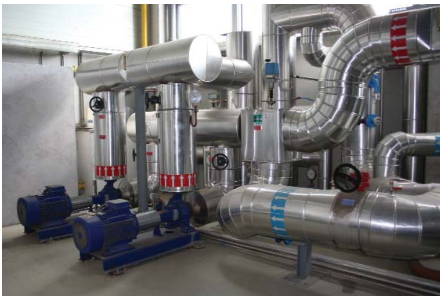
Technologie kotleny se záložním plynovým kotlem
