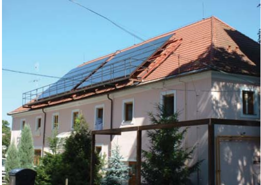
Solární systém na objektu sociální péče (Libnič)
