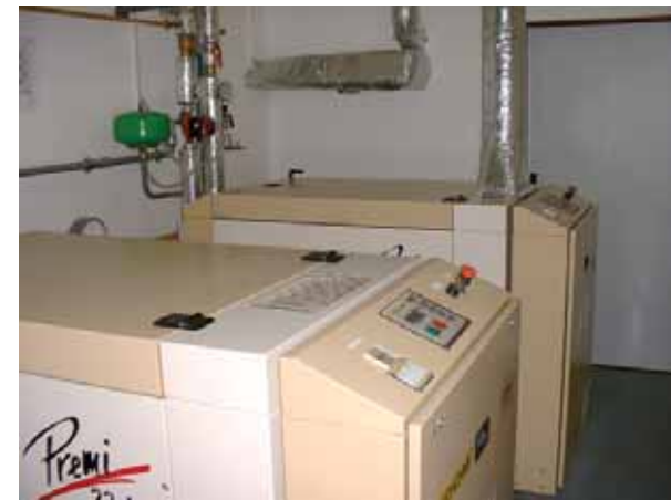
Dvojice menších kogeneračních jednotek pro vytápění a ohřev vody. Foto: EkoWATT
