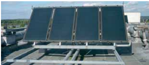
Solární zařízení pro ohřev užitkové vody instalované na panelovém domě v Českých Budějovicích. Dům slouží jako domov seniorů, instalace ušetří ročně kolem 300 tis. Kč. Foto: Vl. Schmidtmayer
