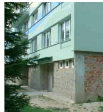
Zateplení štítu je založeno výše než zateplení průčelí, u podlahy prvního patra vzniká tepelný most. Foto: EkoWATT
